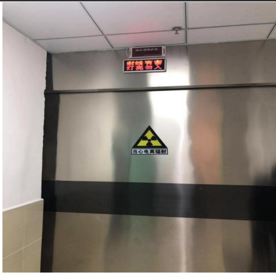
直线加速器机房防护门
