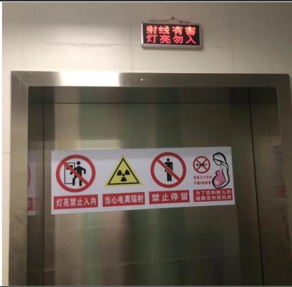
DSA 机房病人防护门（关门）
